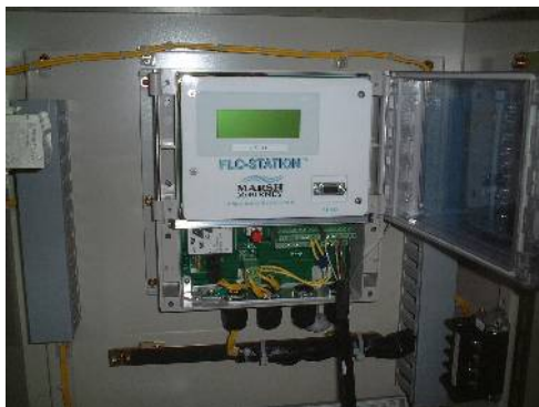
変換器側：盤内に設置
