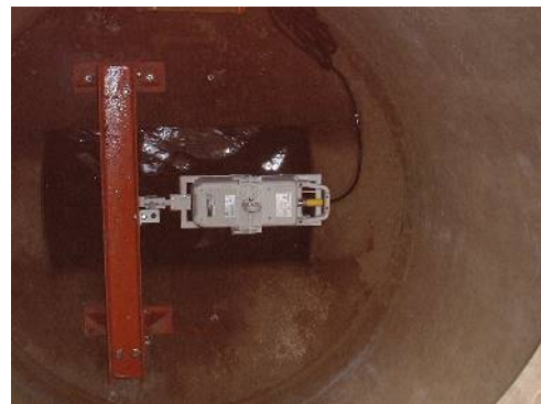
センサ側：既存点検口ピット内に設置
